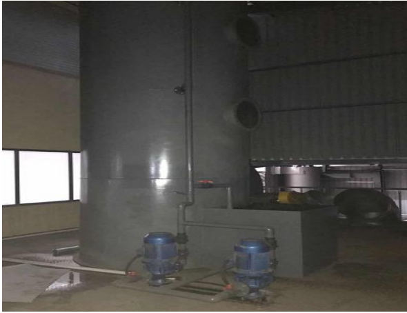
压铸车间除尘装置
