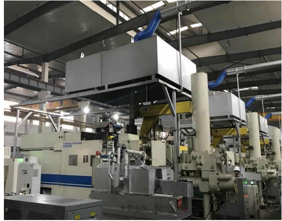
压铸车间除尘装置
