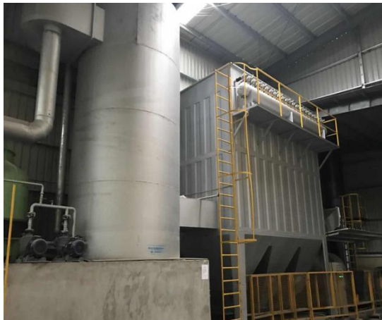
熔炉除尘装置
