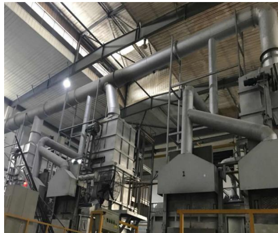
熔炉除尘装置
